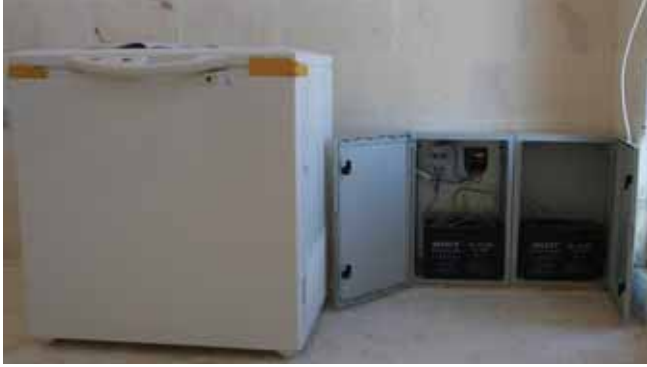
Buzdolabı-Solar kontrol ve batarya Grubu
