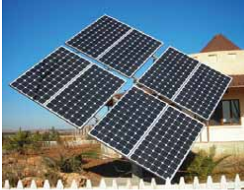
Güneş izleme sistemli PV-panel dizisi
