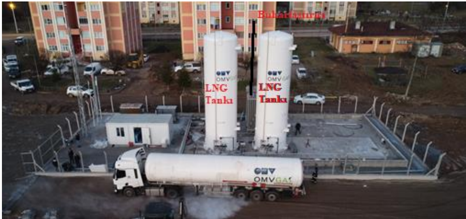
Şekil 16: LNG ile beslenen Bolu Mengen İlçesinin LNG Dağıtım İstasyonu
