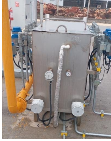
Şekil 12: CNG İstasyonu Isıtma Tankı
