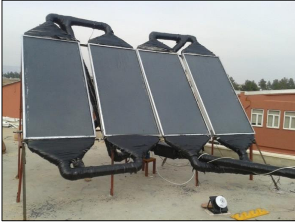
Şekil-5 Hava kanalı yalıtımı yapılmış havalı güneş kollektör grubu
