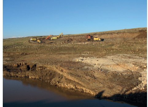
Şekil 24. Siverek/Cehennem Deresi yol göçüğü-2006 taşkın
