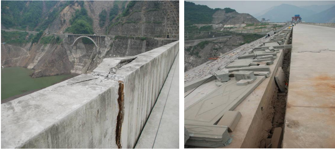
Şekil 6. ZipingPu Barajında Gözlenen Hasar ve Deformasyonlar
