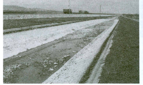
Şekil 4.14. Urfa ana kanalı içerisindeki taş ve kum
