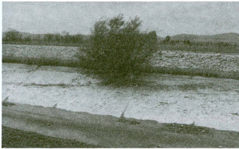
Şekil 4.3. Urfa ana kanalı beton kaplamasında oluşan bitkiler
