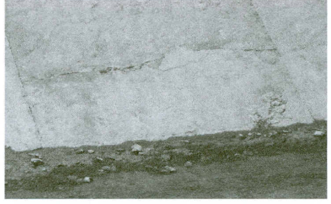
Şekil 4.2. Urfa ana kanalında (UY4) çatlamış ve kısmen oturmuş beton kanalı
