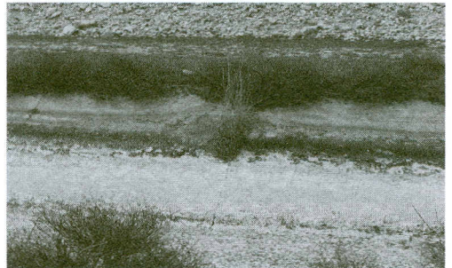
Şekil 4.4. Urfa ana kanalı şevi, derz aralığında oluşan bitkiler
