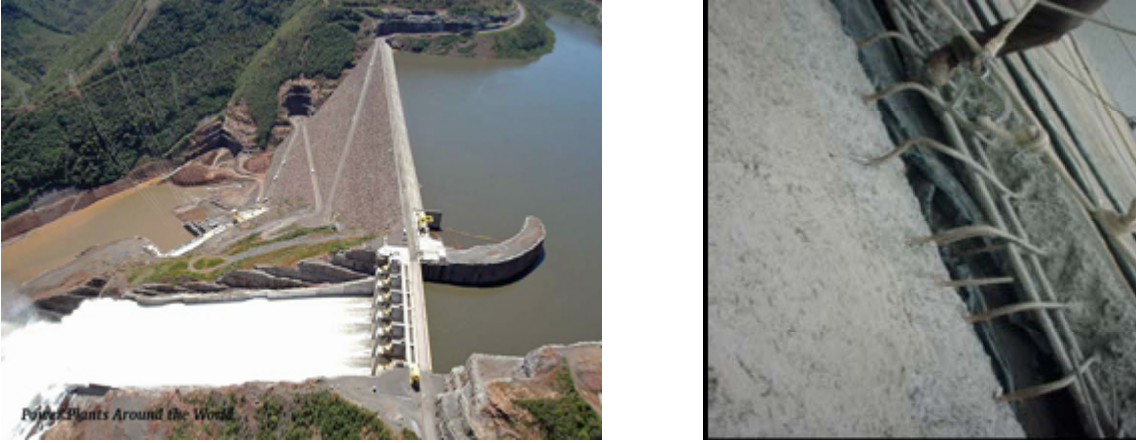
Şekil 2: Barra Grande Barajı ve beton çatlakları (Anonymous, 2013a)
