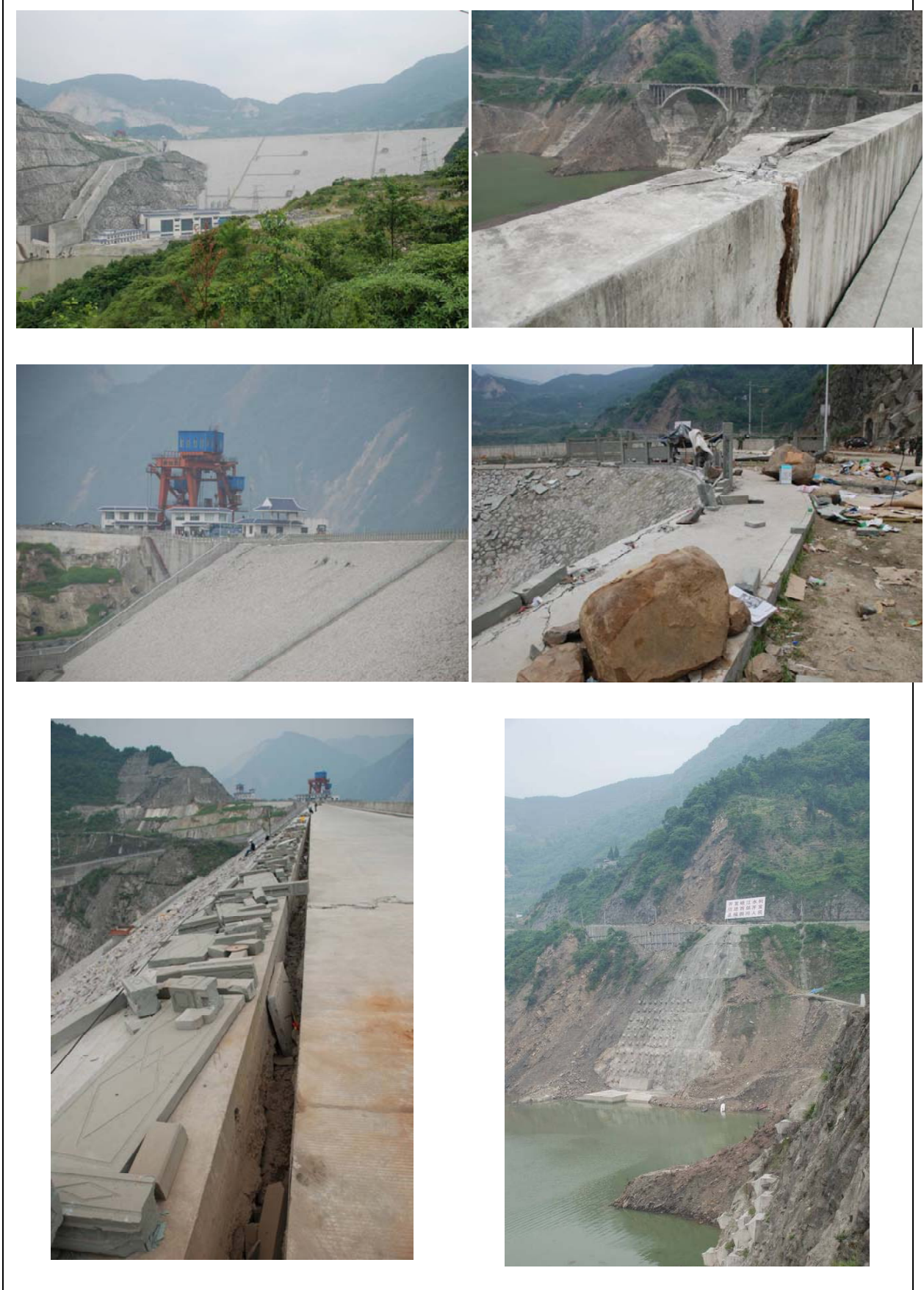
Şekil 6. ZipingPu Barajında Gözlenen Hasar ve Deformasyonlar
