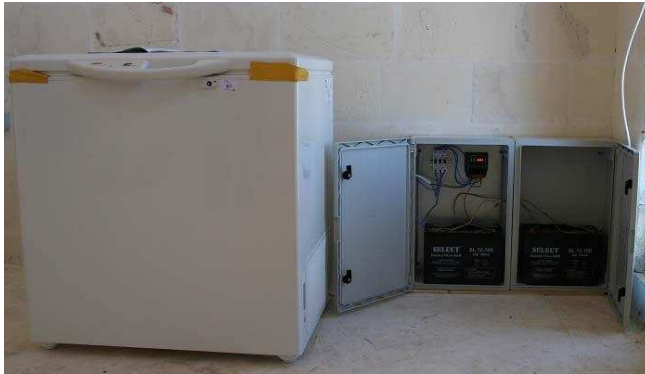
Buzdolabı-Solar Kontrol ve Batarya Grubu
